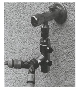
Beispiel frostsichere Entnahmearmatur mit Systemtrenner zur Gartenbewässerung.
